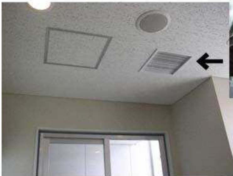
天井に排気口
